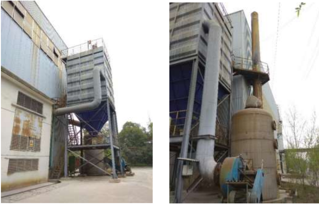
图 4.3-2 同类型脉冲布袋除尘器+氟化塔净化处理装置
