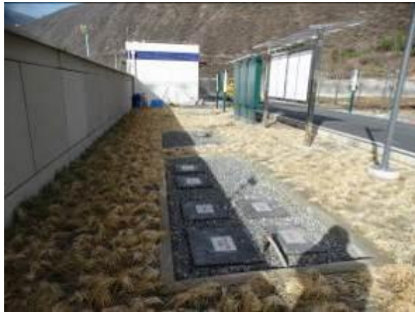
站内地埋式污水处理设施
