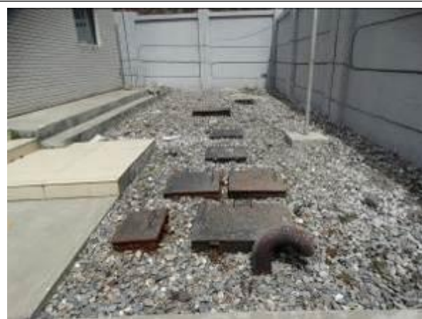
站内地埋式污水处理设施
