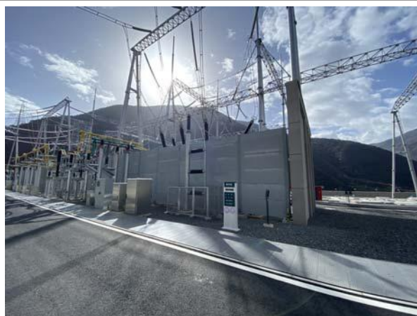
#2 主变北侧隔声屏障
