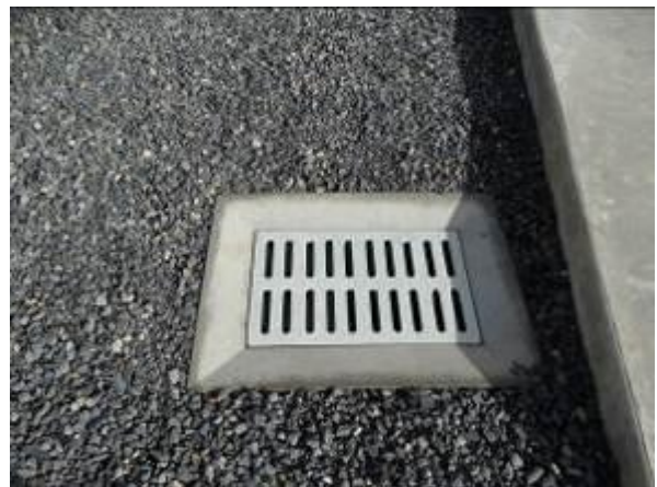
站内雨水集水井
