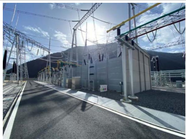
#3 主变北侧隔声屏障
