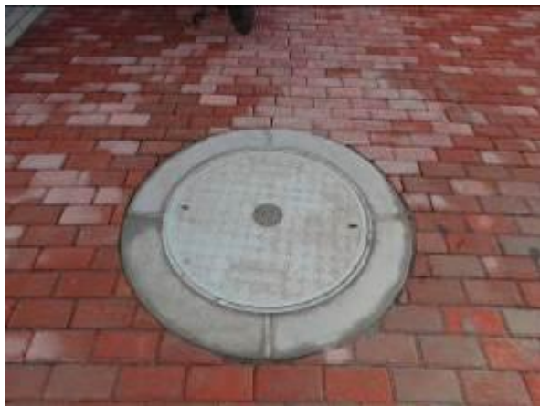
站内雨水检查井
