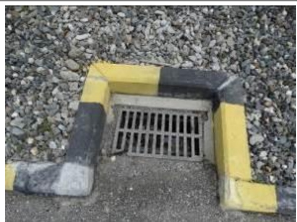
站内雨水集水井
