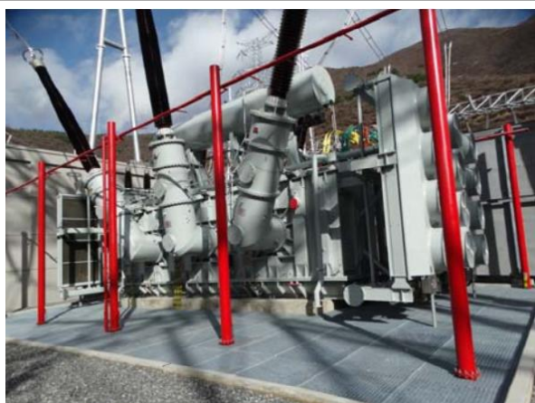
主变下方储油坑
