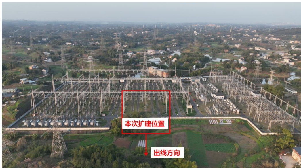
图4-3 泸州500kV变电站现状
