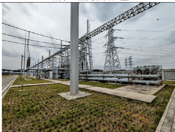
站内 220kV 配电装置区
