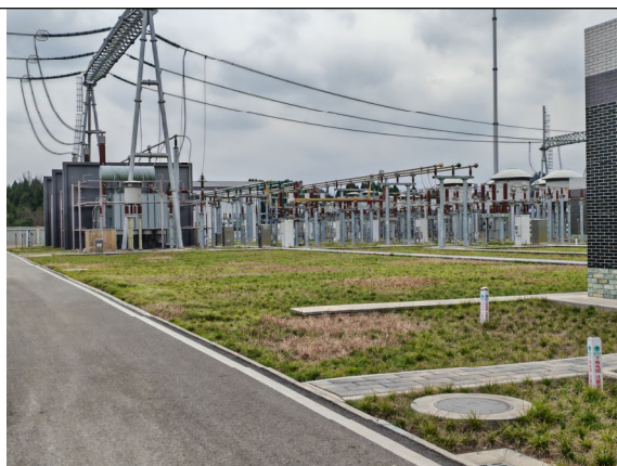
站内 2#主变预留位置
