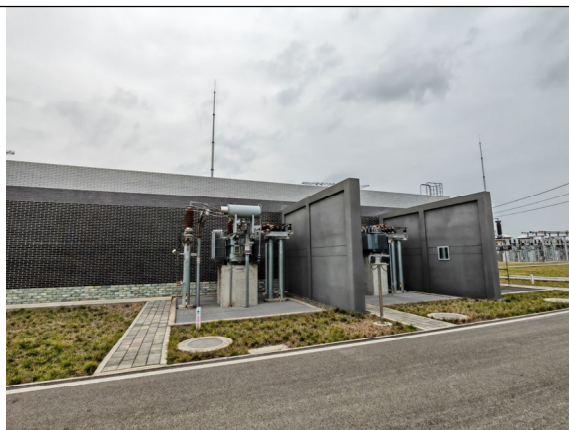
站内现有站用变及蓄电池室
