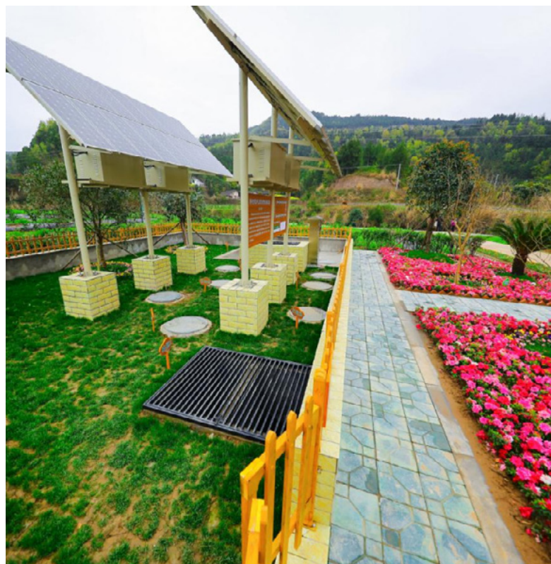
阆中市五龙村污水处理站
