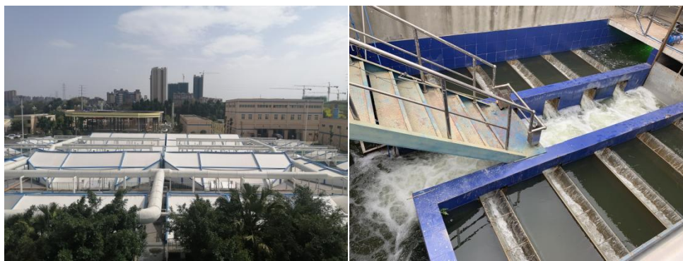
图 2-18 城市生活污水处理厂基于高效低耗平板膜污水处理工艺（左：项目全景；右：污染治理效果）
