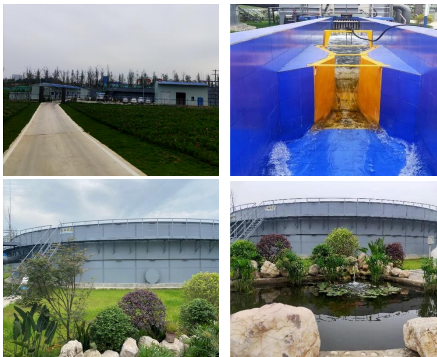
图 2-16 怡心湖 3C-BACT 提标改造示范项目（左上：项目全景；左下：项目主要工艺设备；右上：污染治理效果、产品；右下：出水回用作为厂内景观水）
