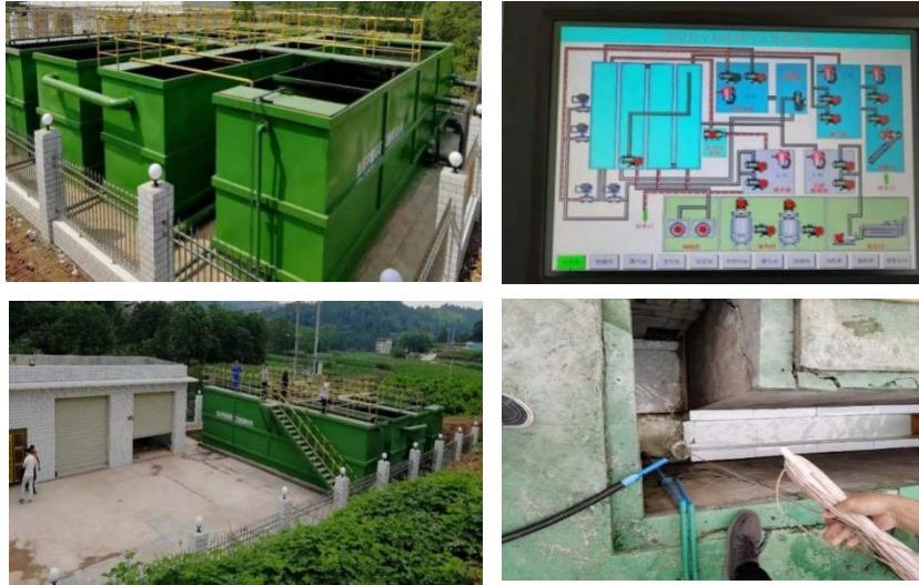
图 2-12 乐至县中和场镇生活污水 MBBR-DNBF 处理站工程项目
