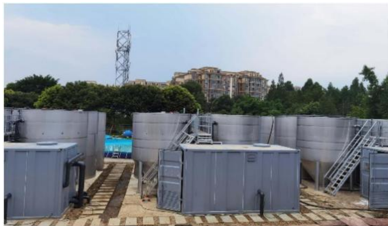
图 2-8 蒲江县寿安占河应急污水处理项目主要工艺设备
