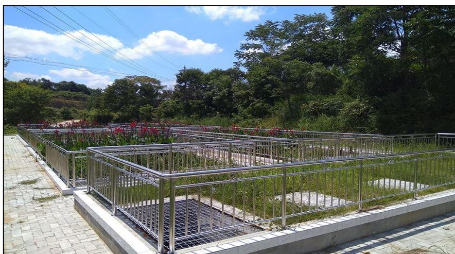
图 4-24 “预处理+A/O+人工湿地” 工艺全景图
