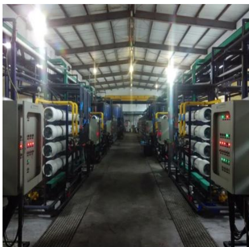
图 3-10 草甘膦母液处理项目的膜处理装置
