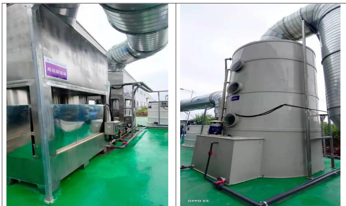
图 6-16 废线路板拆解烟气治理设备
