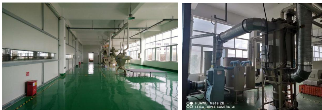
图 6-14 废荧光灯及其他含汞电光源无害化处置现场
