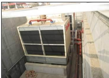
下沉式冷却塔
