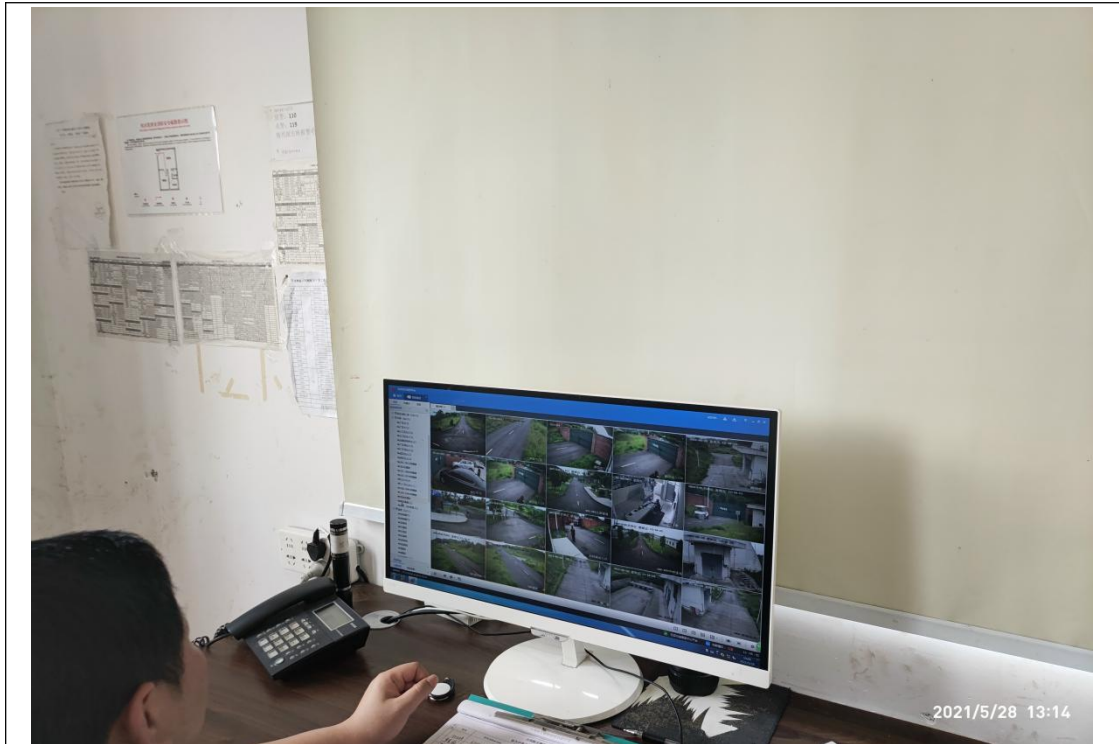
图 10-2 川南航天能源科技有限公司民爆仓库厂区现有监控系统
