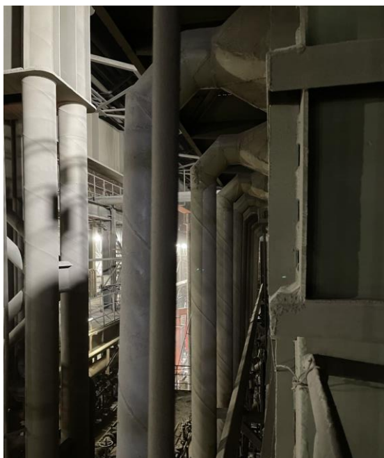
图 2.6-2 现状 1#RH 真空精炼炉料仓抽风系统
