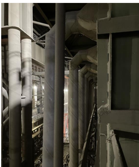
图 3.3-1 各料仓上料粉尘负压集气设施
