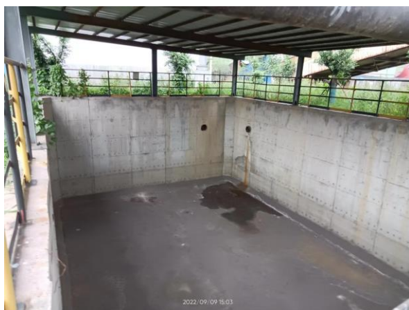
泄露液收集池
