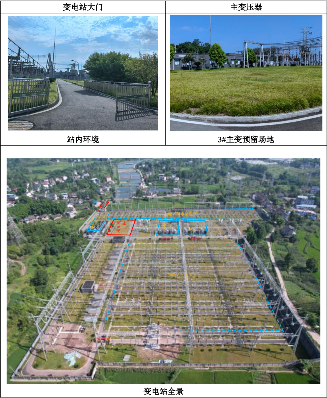
图 3-1 500kV 南充变电站现状
