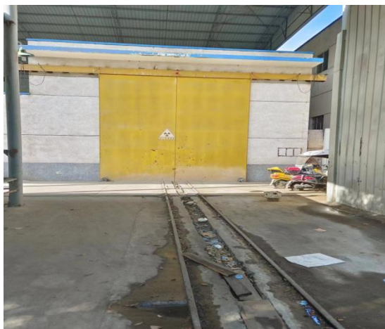
探伤室工件进出门现状
