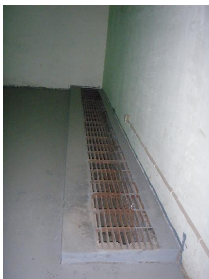
曝光室内排气通道
