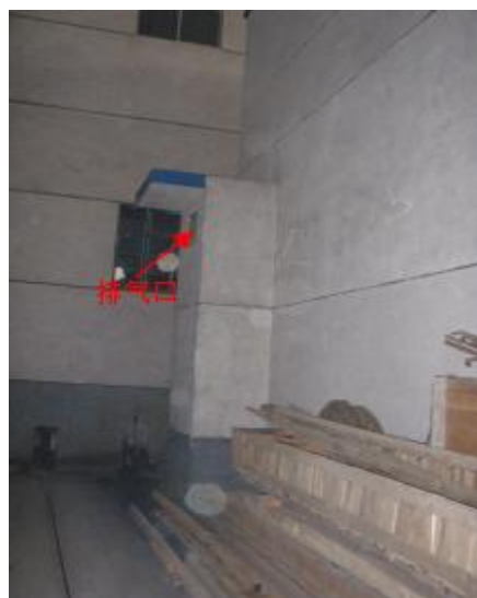
曝光室外排气通道
