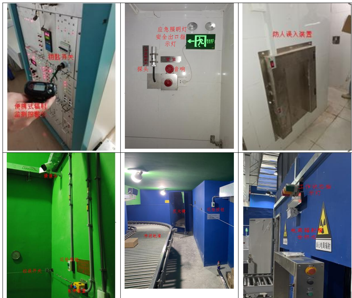
图 10-6 同类型加速器的安全装置和防护措施现场照片
