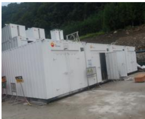
图 13.1-5 类比同类型钻井工程已建发电房现场实景图
