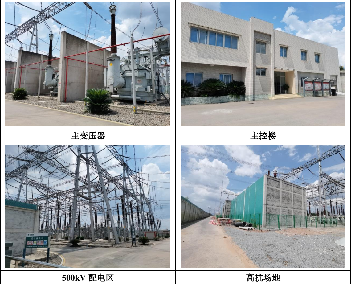
图 3-2 500kV 巴中变电站现状
